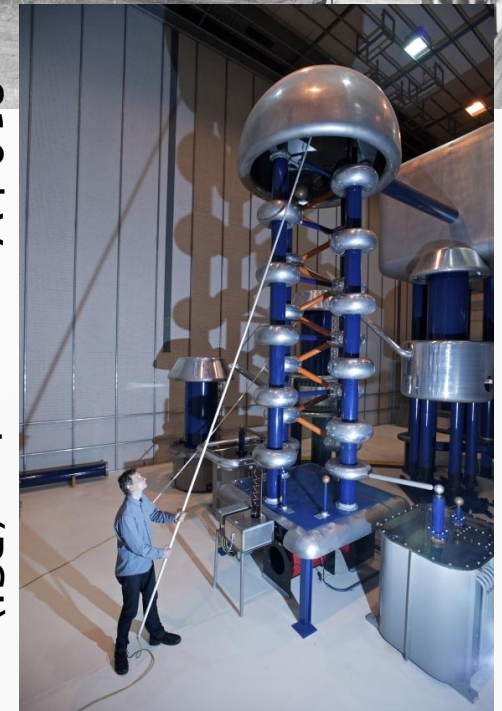
810 kV generator (PSI)
