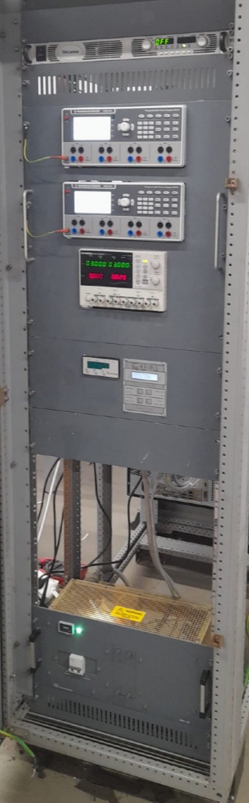
Güç Kaynağı & Vakum Rack
