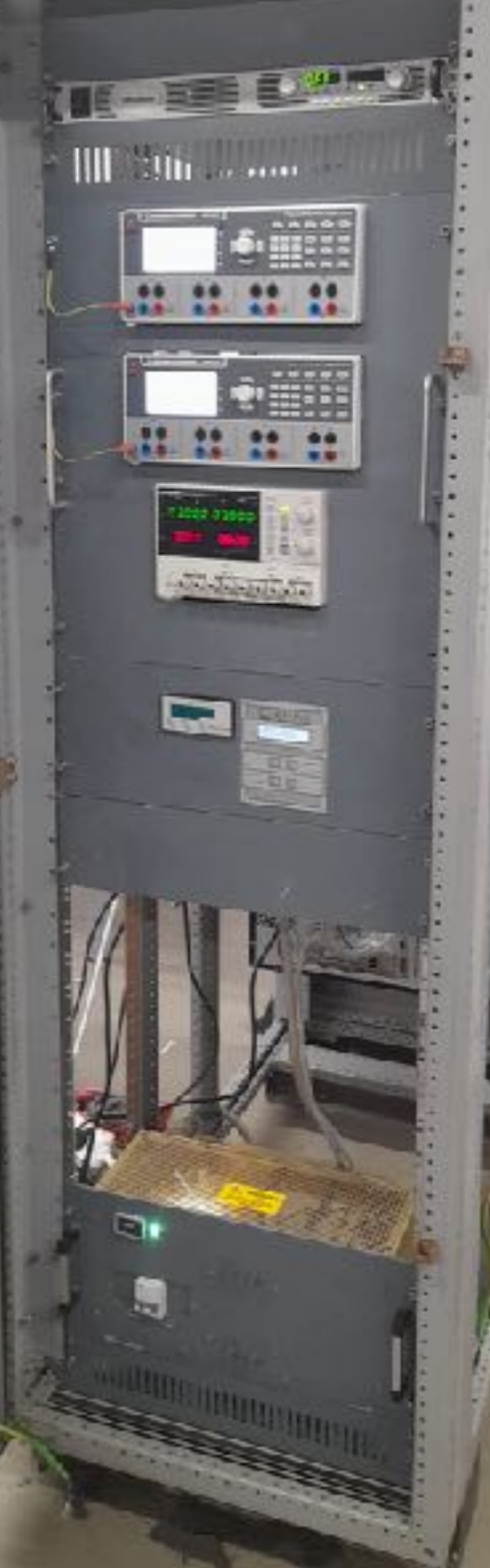
Güç Kaynağı & Vakum Rack
