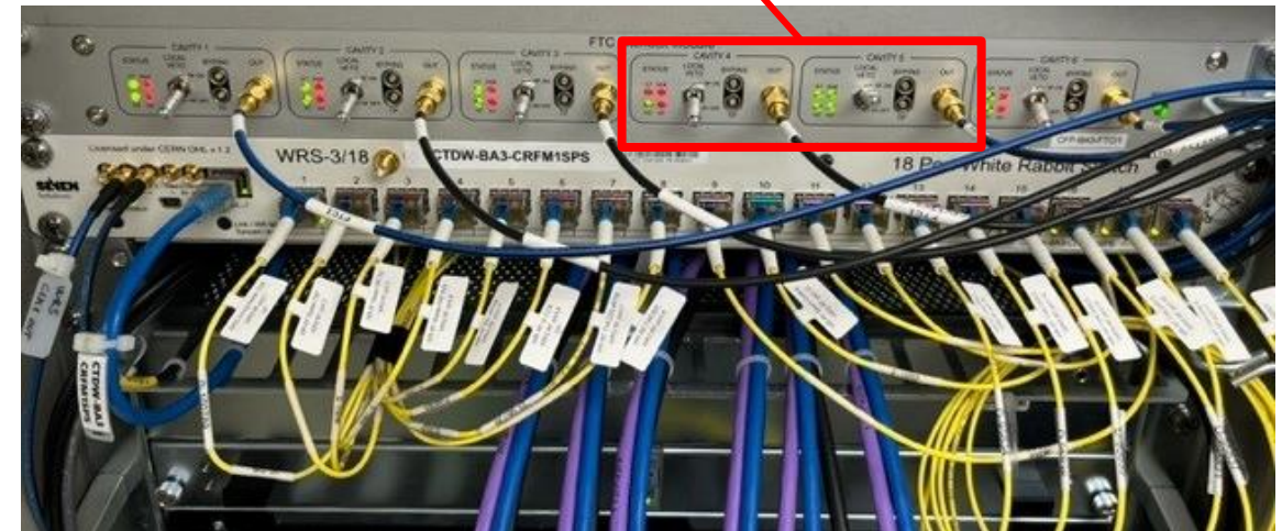
Fig – Interlock module FTCl
