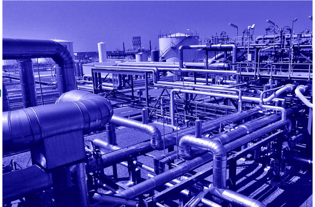
LNG RECEIVING TERMINAL BILBAO SPAIN
