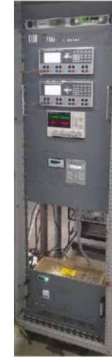
Güç Kaynağı & Vakum Rack
