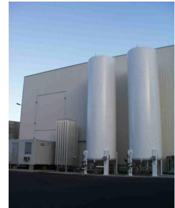
LN2 existing 50 m3
