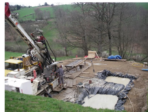
Sondage A89 (2007) incliné de 45° de 125 ml (surface plateforme estimée: 12 x 12 m soit environ 150 m²)
