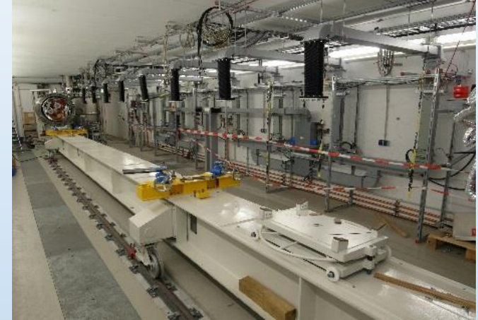
Cryomodule test stand
