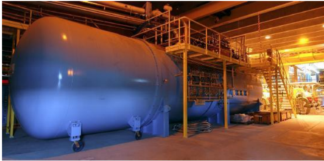
Cold box του 18 kW refrigerator @ 4.5 K
