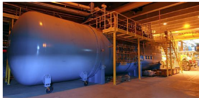
Cold box του 18 kW refrigerator @ 4.5 K
