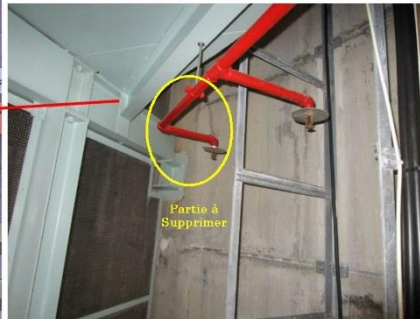
Conflit des lignes cryogéniques avec les tuyaux incendie
