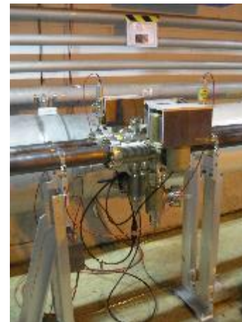
Ion pump modules
