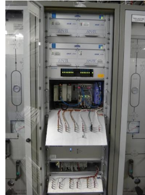
Controls module 60 PLCs
