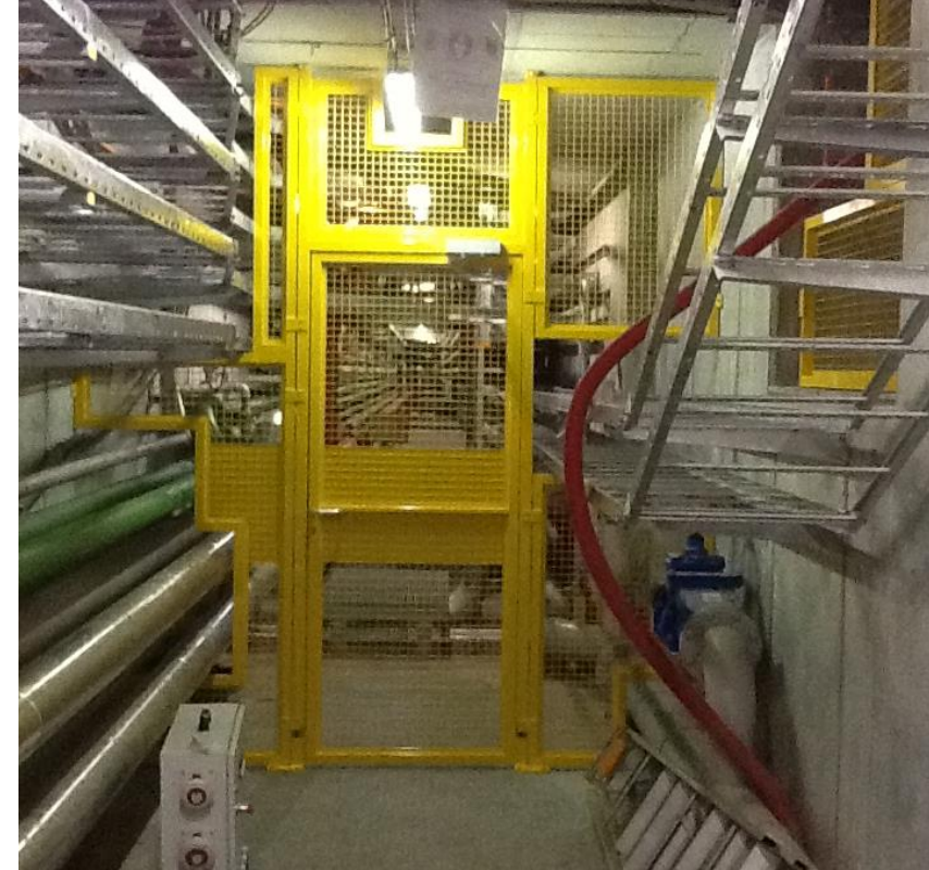
Séparation avec GNH106
