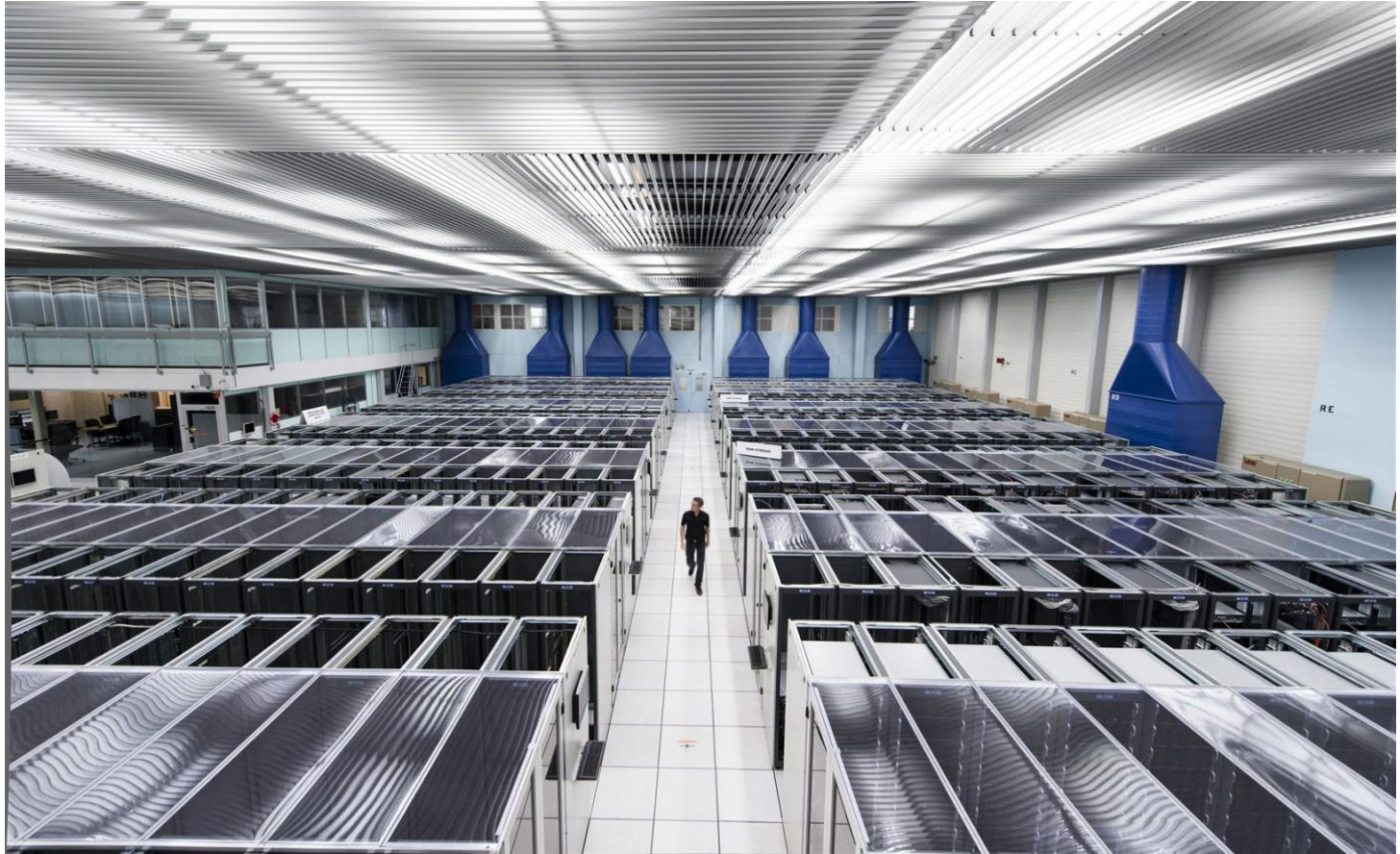
Server Farm im 1450 m 2 großen Hauptraum des Data Centers
