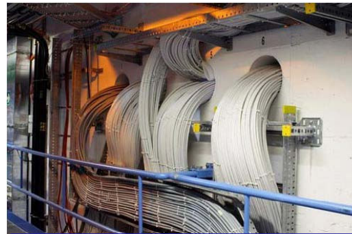
ATLAS Inner Det. Cables
