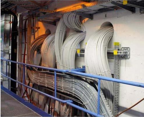
ATLAS Inner Det. Cables
