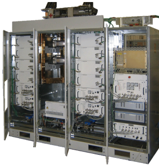
▲ Actual 1-quadrant 6 kA converter
