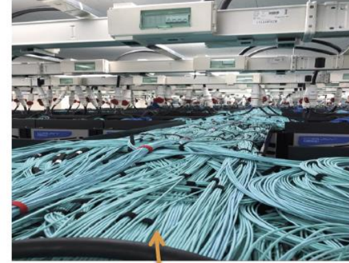
OPA Optic Cables
