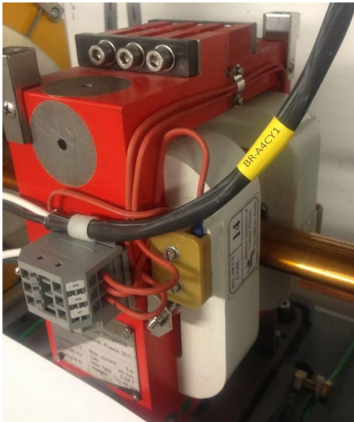
горизонтальный корректирующий магнит дипольный X корректор
