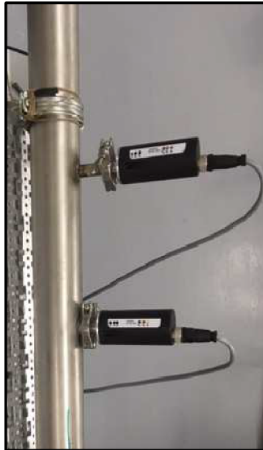
Capteurs sur canalisation
