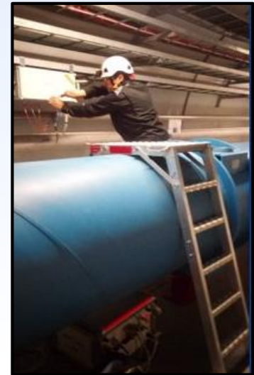
VRJGE box modifications
