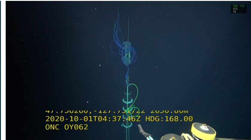
Mini Junction Box (MJB)
